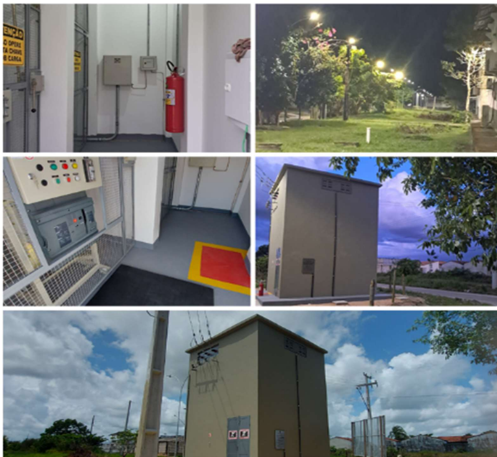
Cabine de Medição e iluminação elétrica - Campus Capitão-Poço Fotos: Arquivo/ DPO.
